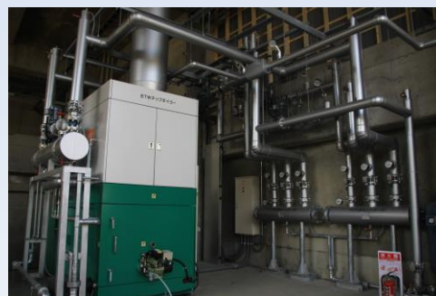
(普代村：くろさき荘のチップボイラー)
