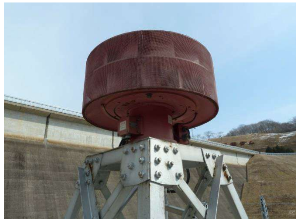
四十四田発電所サイレン
