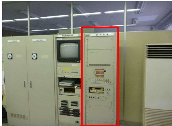
副局（御所発電所）
