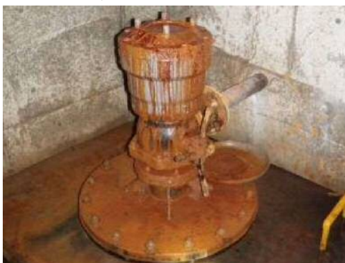
空気弁（錆の発生）
