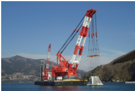
大船渡港湾口防波堤の工事の様子（写真提供：国土交通省東北地方整備局釜石港湾事務所）
