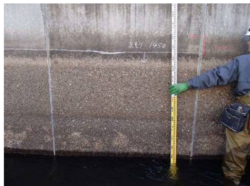
接水部の摩耗状況
