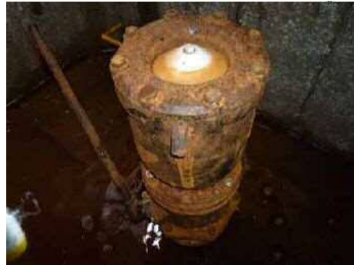
空気弁（錆の発生）
