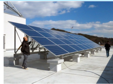
【大槌消防署の太陽光発電設備】
