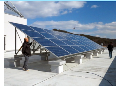
【大槌消防署の太陽光発電設備】
