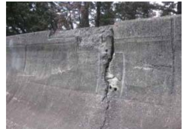
堤防におけるコンクリート手すりの破損及び応急措置状況の剥離状況
