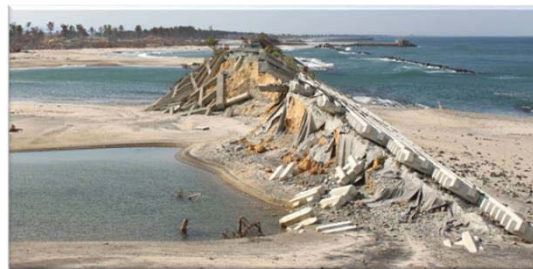
東日本大震災における堤防の破壊
