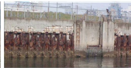
鋼矢板の腐食・コンクリートの劣化
