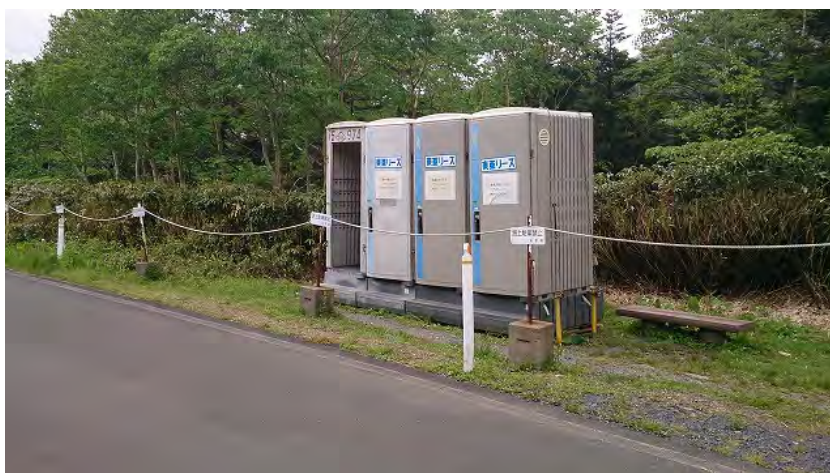
小田越登山口に設置した仮設トイレ
