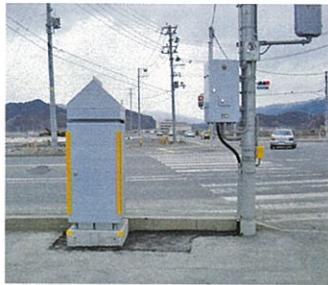
信号機電源付加装置（写真左）
