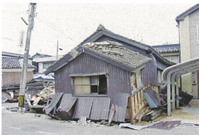
地震により倒壊した木造住宅
