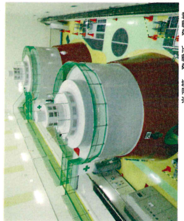
岩洞第一発電所・発電機
