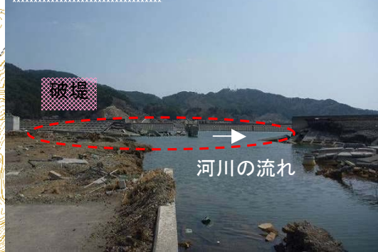
⑥小槌川堤防 被災
