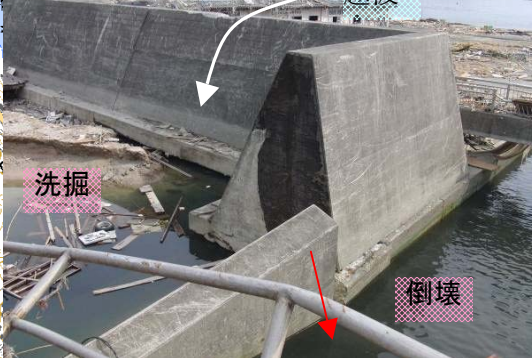
④漁港防潮堤 被災
