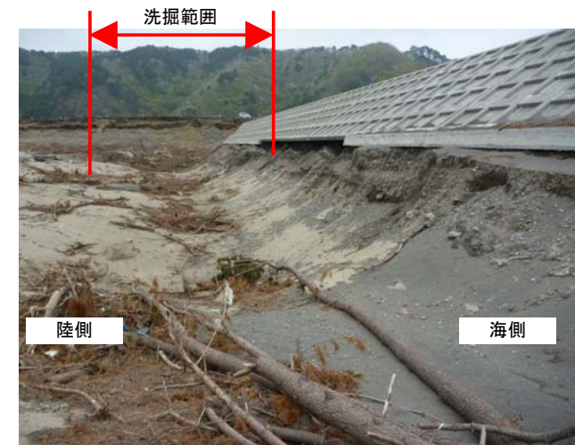
洗掘状況 代表写真
