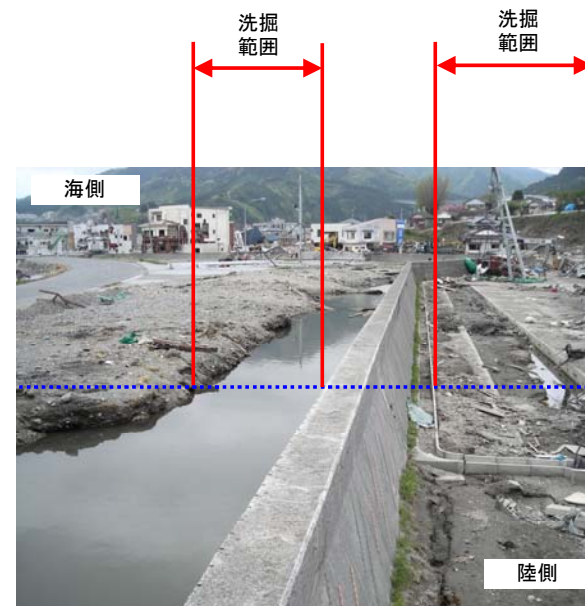
洗掘状況 代表写真
