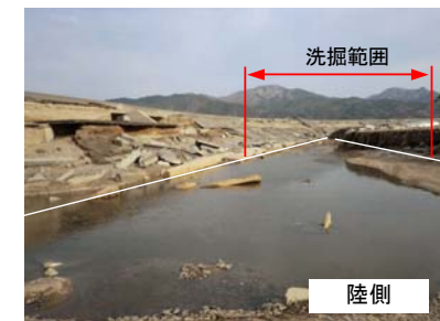
洗掘状況 代表写真
