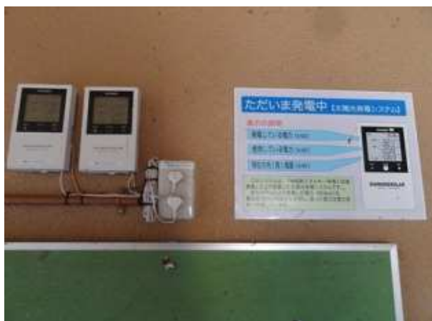
太陽光パネル発電システム
