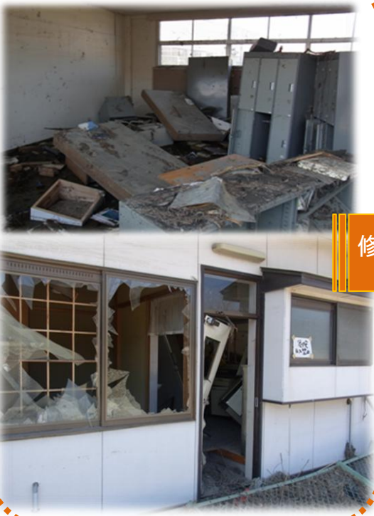
被災訓練施設
