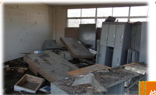
被災訓練施設
