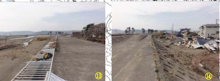
久慈湊漁港海岸の久慈川左岸の裏のりは津波の越流により損壊が見られる。表側には損壊はない。背後地の家屋の損傷は一部全壊もあるが、その範囲は広くない。(写真⑪～⑭)
