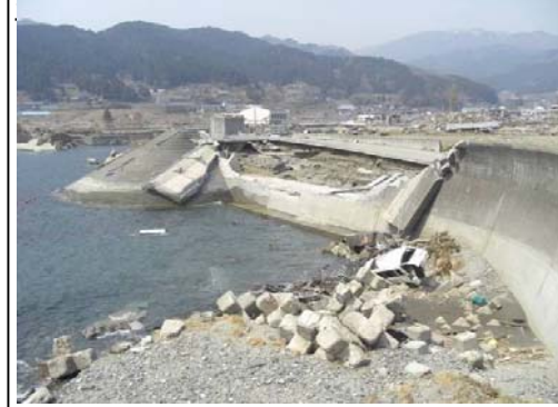
防潮堤被災区間(裏法被覆工あり: 破堤)
