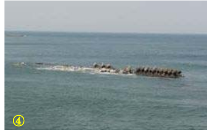
離岸堤の一部が被災し、破壊もしくは流出している（写真④）。
