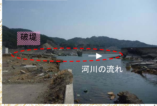
⑥小槌川堤防 被災
