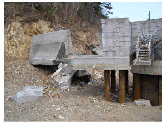
押し波により陸側の扉体、門柱流失 引き波により陸側基礎洗掘流失
