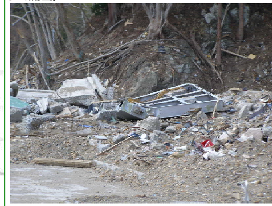
押し波により陸側が倒壊し、扉体が陸側100mの位置まで流出。
