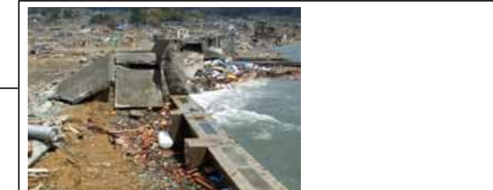
防潮堤本体工の倒壊(約70m)
