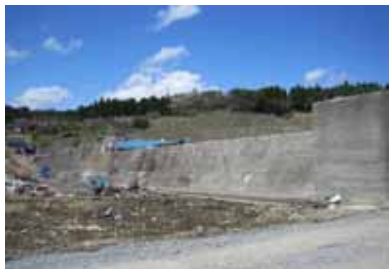
防潮堤の上部(高さ30cm程度)が約30mにわたり剥落している。
