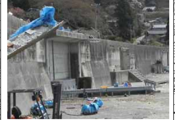
津波の越流により水門上屋が流失
