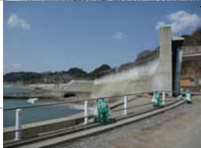
防潮堤表法本体に大きな被害は見られないが、一部法尻部に吸出しが見られる(幅 5m x 3m 程度)。
