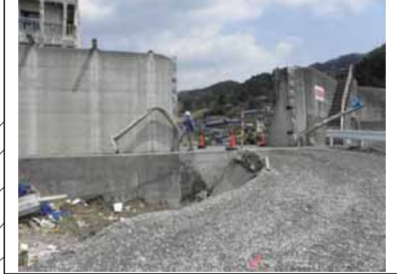
引き波により陸閘の扉体流失
