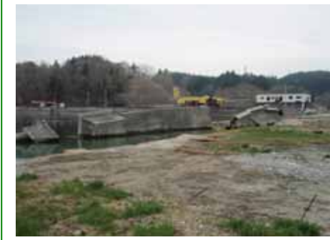
押し波により防潮堤、陸間が陸側に破損
