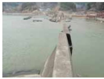
引き波により防潮堤が海側に倒壊
