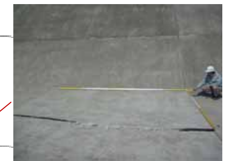
堤坂路基礎の浮き、手摺りの損傷、防潮堤前面のコンクリートの浮きが確認されている。
