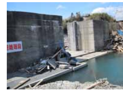
津波による扉体の消失
