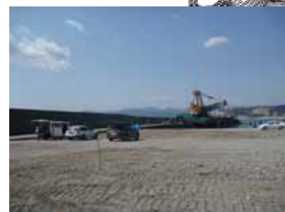
南防波堤は重機船が乗り上げているが、大きな破損は見られない。
