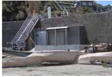
避難階段の手すりの破損があるが陸閘は健全な状態にある。
