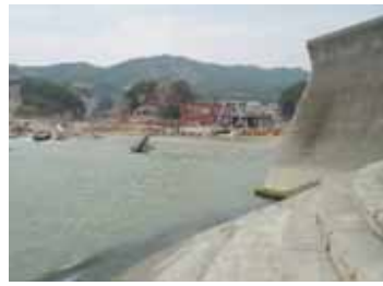
押し波により、防潮堤が陸側に全壊
