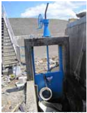
樋体の巻上げ装置が損傷(軸の折れ曲がり)
