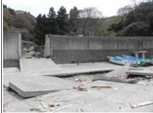
引き波により陸閘の扉体流失
