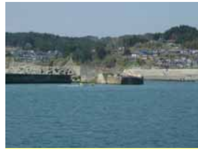
沖防波堤が一部転倒、流出している。
