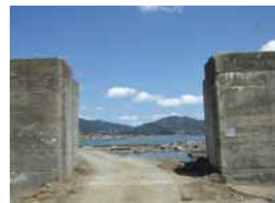
津波による扉体の消失
