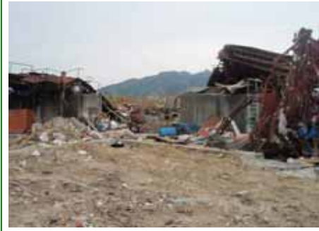
押し波により陸間が陸側に破損
