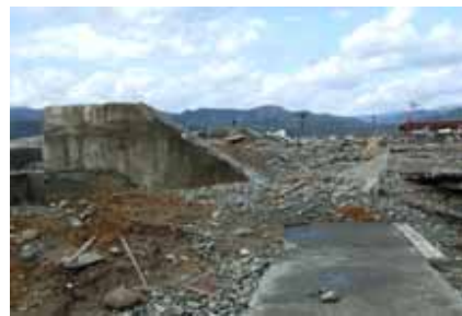
防潮堤の全壊(約240m)
