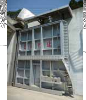
2号陸開は、ゲートが損傷しており、引き波により破損したと思われる(マイターゲート)。
