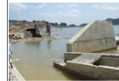
防潮堤の破堤(約40m)
