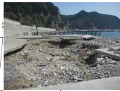
防潮堤前面の広場の天端コンクリートが流出している。
