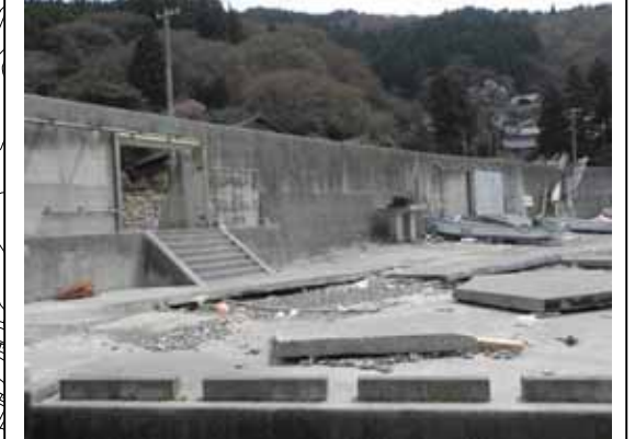
引き波により陸閘の扉体流失
