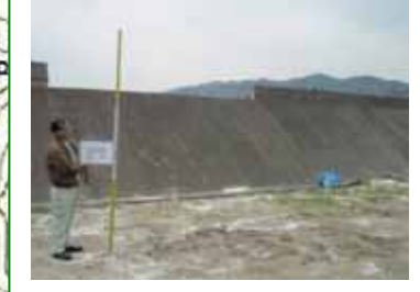
越流により上部工一部が損壊
