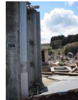
片方の扉体が消失している。
