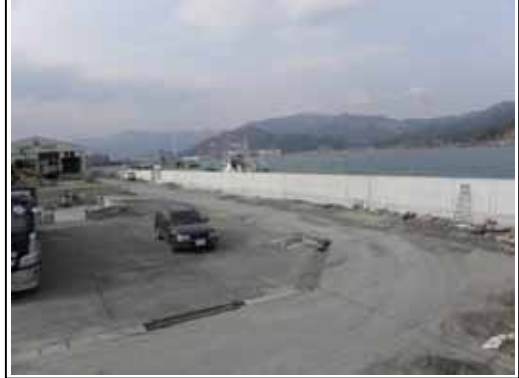
防潮堤端部の洗掘(防潮堤の前後で洗掘)
