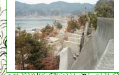
引き波により表法、天端コンクリート倒壊
