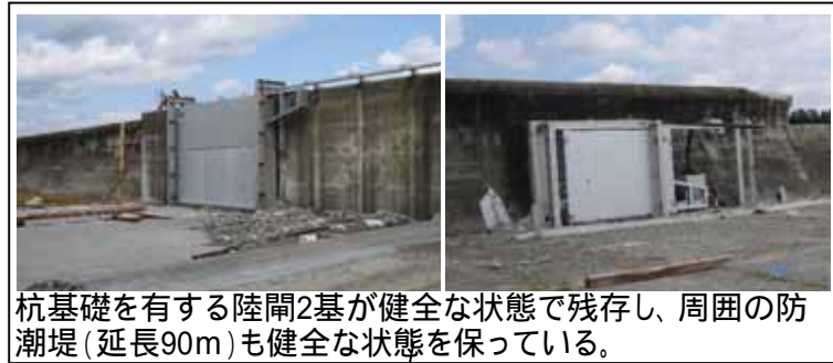
陸閘と周囲防潮堤の残存(約90m)
