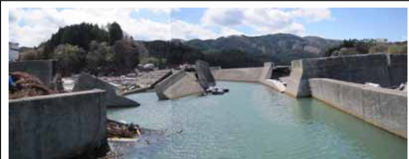
河川護岸との取付部で破堤している。河川護岸の越流等による乱流の発生で基礎地盤が洗掘され破堤したものと推定される。
