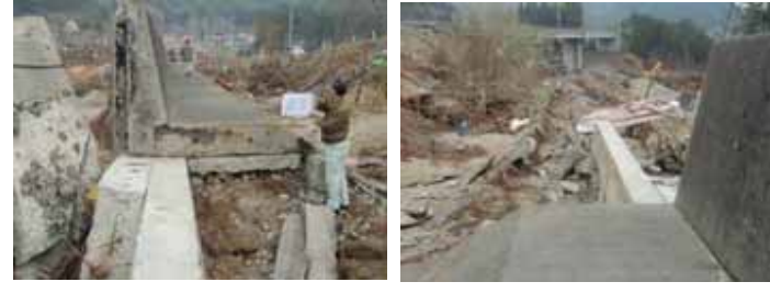
引き波により防潮堤が海側に倒壊
