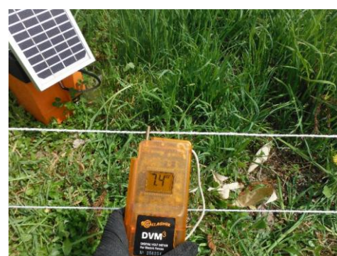
写真5 電圧は5,000ボルト以上を確保
