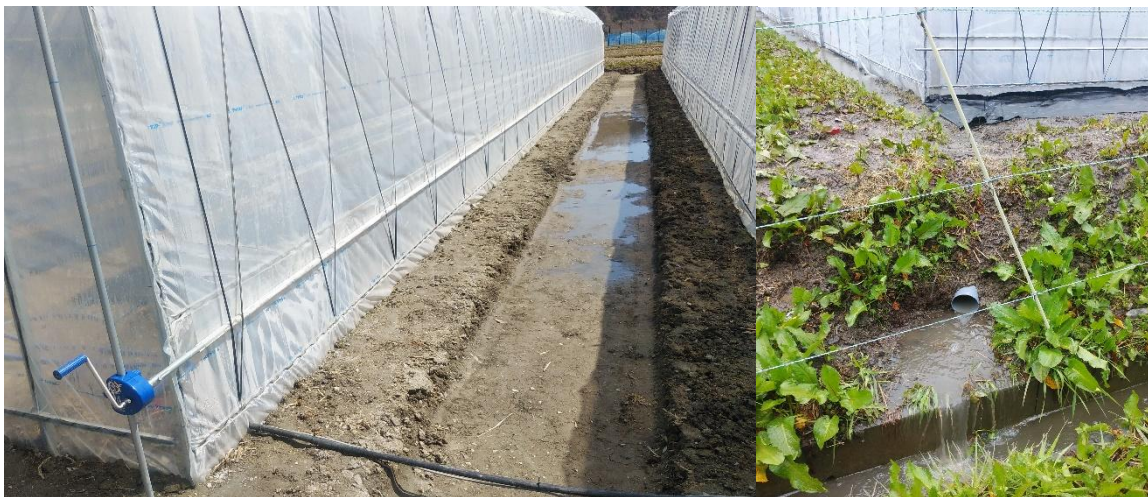
写真1 左：ハウス周囲の明きょ設置状況 右：降雨時の排水路への排水状況
