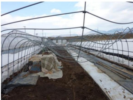
単棟パイプハウスのM字型陥没
