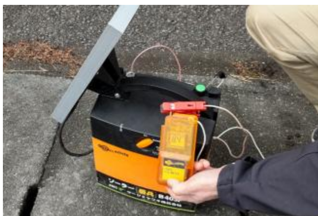
写真1 パワーユニットの点検(この事例では、無負荷で電圧は8.4KVであり、正常と判断した)
