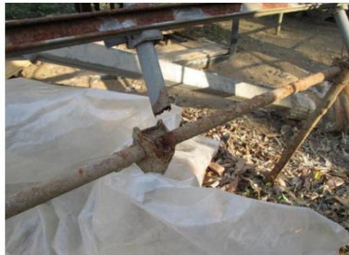
地際部の腐食による折れ
