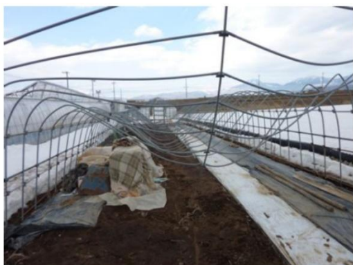
単棟パイプハウスのM字型陥没
