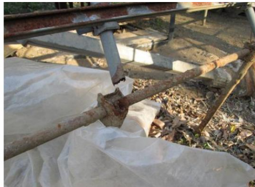
地際部の腐食による折れ
