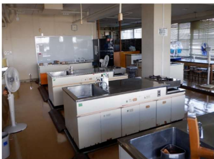
調理実習室 （漏水が発生、エアコンなし）
