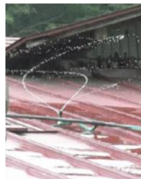
【気化熱】屋根への散水
