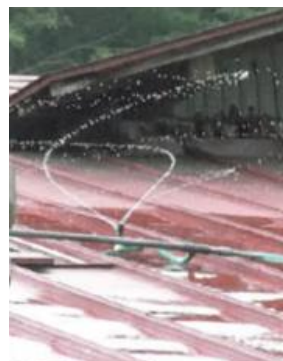
【気化熱】屋根への散水
