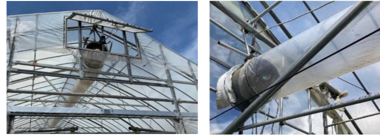
外気導入装置（循環扇+通風用ダクト）
