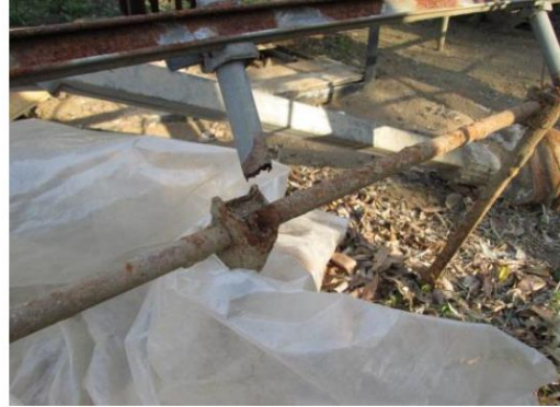
地際部の腐食による折れ
