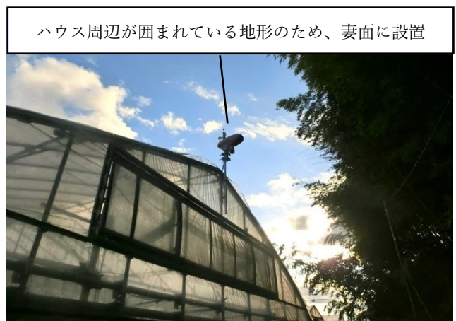
外気象センサーは妻面上部に設置
