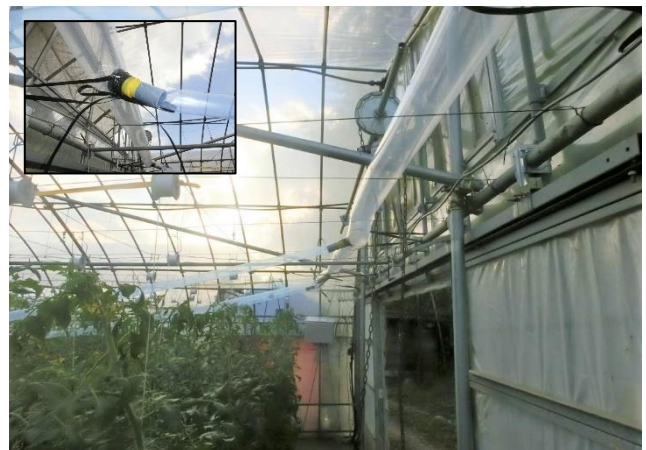
親ダクトはワイヤー上に設置
