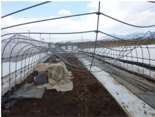
単棟パイプハウスのM字型陥没
