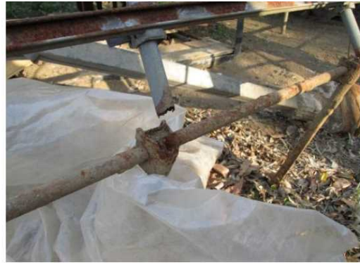
地際部の腐食による折れ
