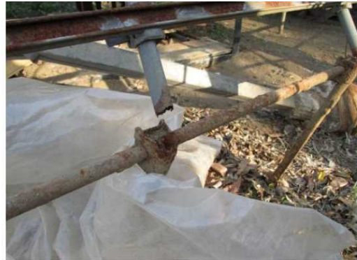
地際部の腐食による折れ
