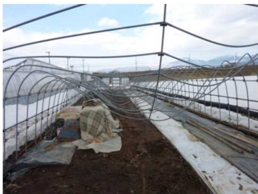
単棟パイプハウスのM字型陥没
