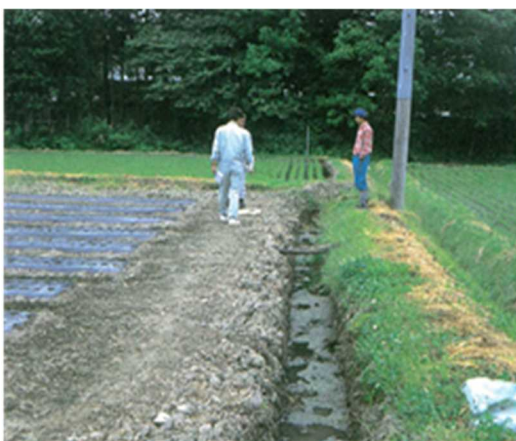
明きよ設置事例
