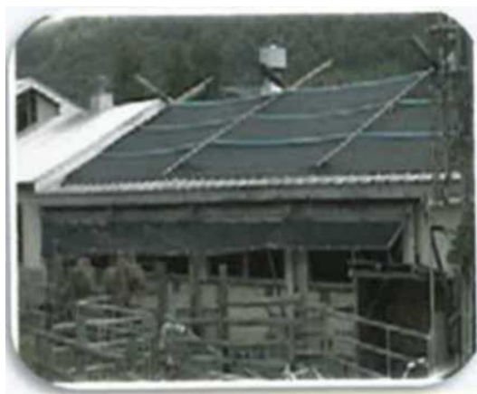
写真1 屋根表面への寒冷紗の設置 ※屋根と寒冷紗の間に角材等ですき間を設けると断熱効果が上がる
