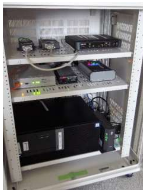
サーバ (本館3階)
