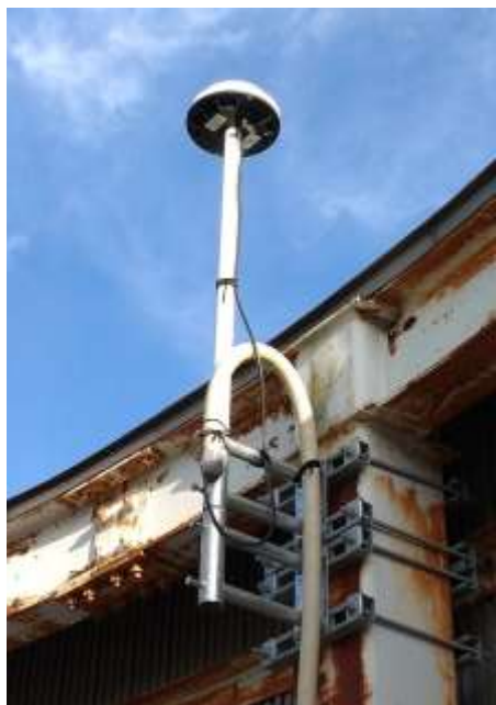
アンテナ (本館屋上)
