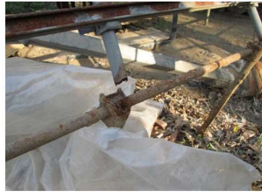
地際部の腐食による折れ
