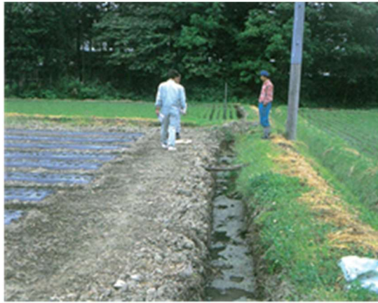
写真1 明きよ設置事例
