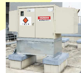
非常用発電機
