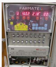
複合環境制御盤
