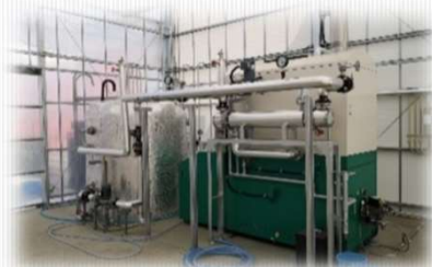
チップボイラー
