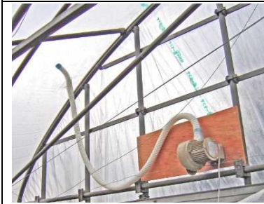
図 8 - 2 ハウス内部に設置したブロワにより送風
