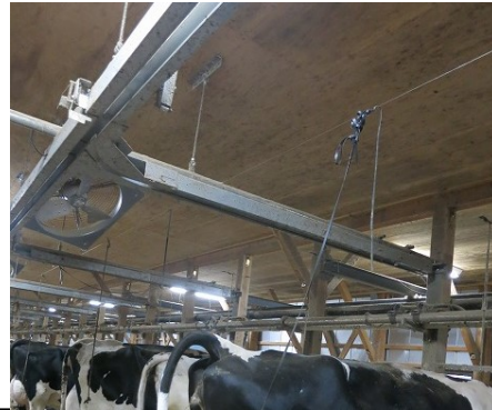
写真4 トンネル換気で天井付近にも換気扇を設置した事例
