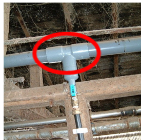
写真5 配管を太くすることで一度に十分な水量を供給できます。
