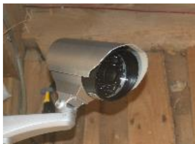
写真1 防犯カメラを活用した看視カメラ
