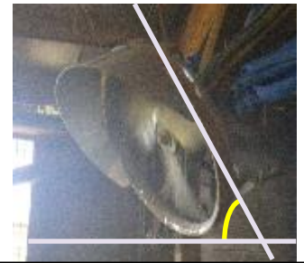
写真3 換気扇角度に注意
