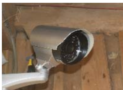
写真1 防犯カメラを活用した看視カメラ
