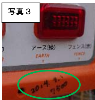
設置日と電圧を記録
