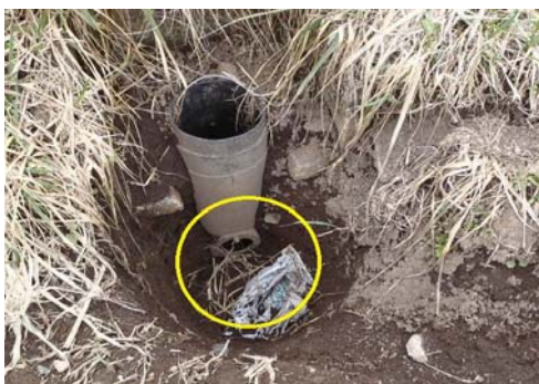
写真3 明渠からの排水が確実に圃場の外へ流れるよう、排水口を掘り下げます。ゴミなどが溜まっていると、スムーズに排水できなくなりますので、点検し、取り除きましょう。
