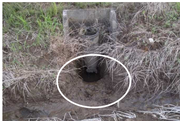
写真2 排水口の掘り下げ 水尻は大きく掘り下げ、排水溝とつなげ、フリードレン下部から排水。
