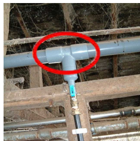
配管を太くすることで一度に十分な水量を供給できます。
