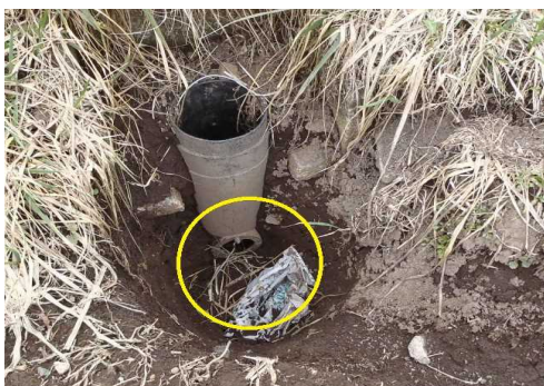
写真3 明渠からの排水が確実に圃場の外へ流れるよう、排水口を掘り下げます。ゴミなどが溜まっていると、スムーズに排水できなくなりますので、点検し、取り除きます。
