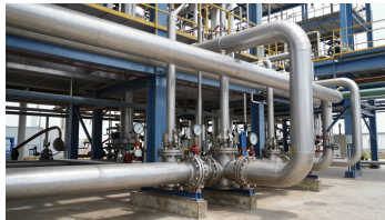
プラント配管
